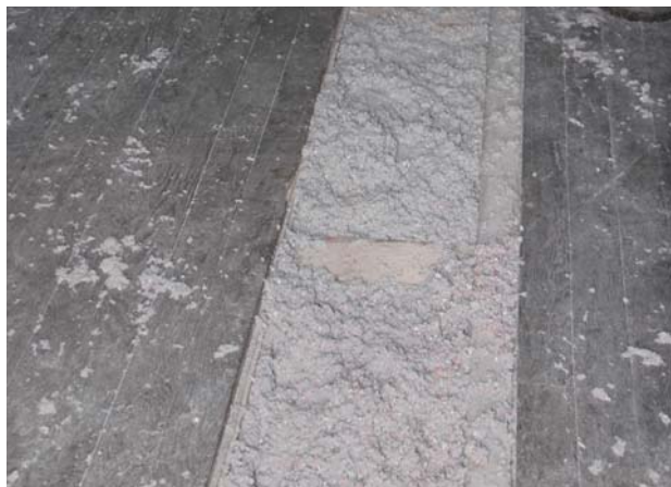
Isolation d'un plancher en ouate de cellulose, dans une maison à ÉCROUVES Photo de LUCIE BLUM et Audrey ROGEZ
